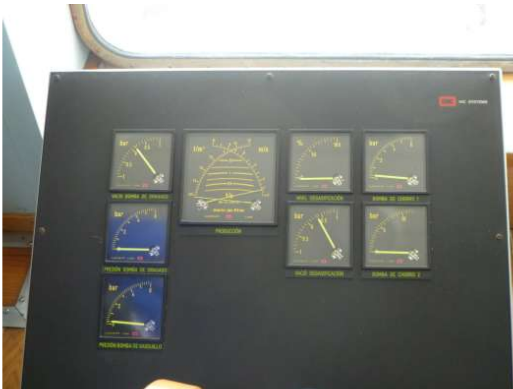
Fotografía 3. Panel de control de parámetros de dragado, ubicado en el puente de mando de la Draga Francisco de Orellana.
