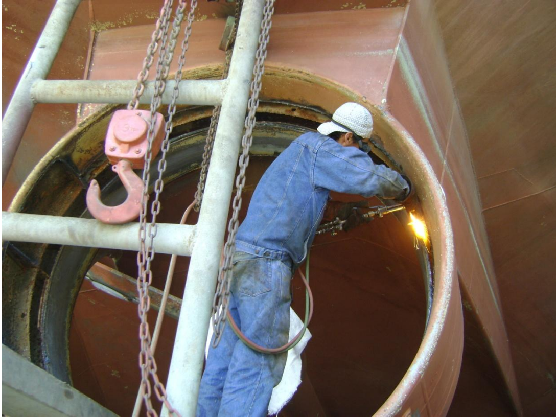
Fotografía 3. Trabajos de soldadura durante etapa de mantenimiento de la Draga Francisco de Orellana.
