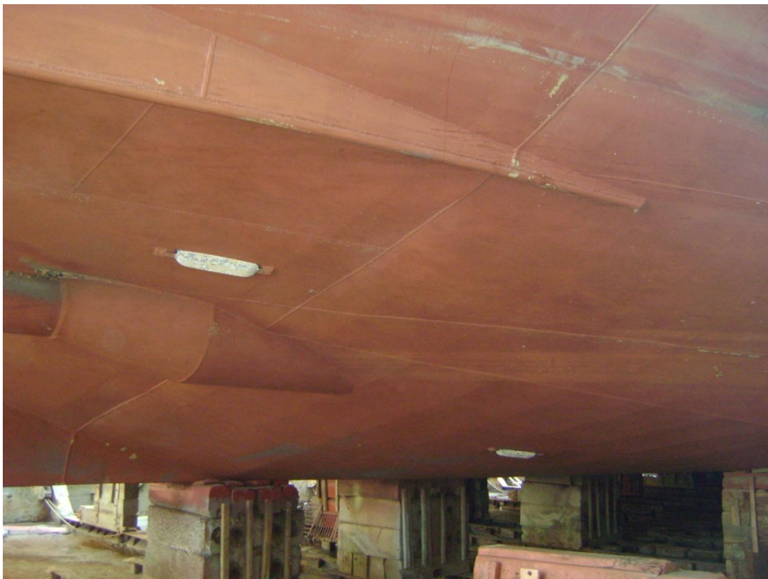
Fotografía 4. Vista general de distribución de ánodos de sacrificio (panes de zinc) para control de la corrosión del casco de la DRAFOR.
