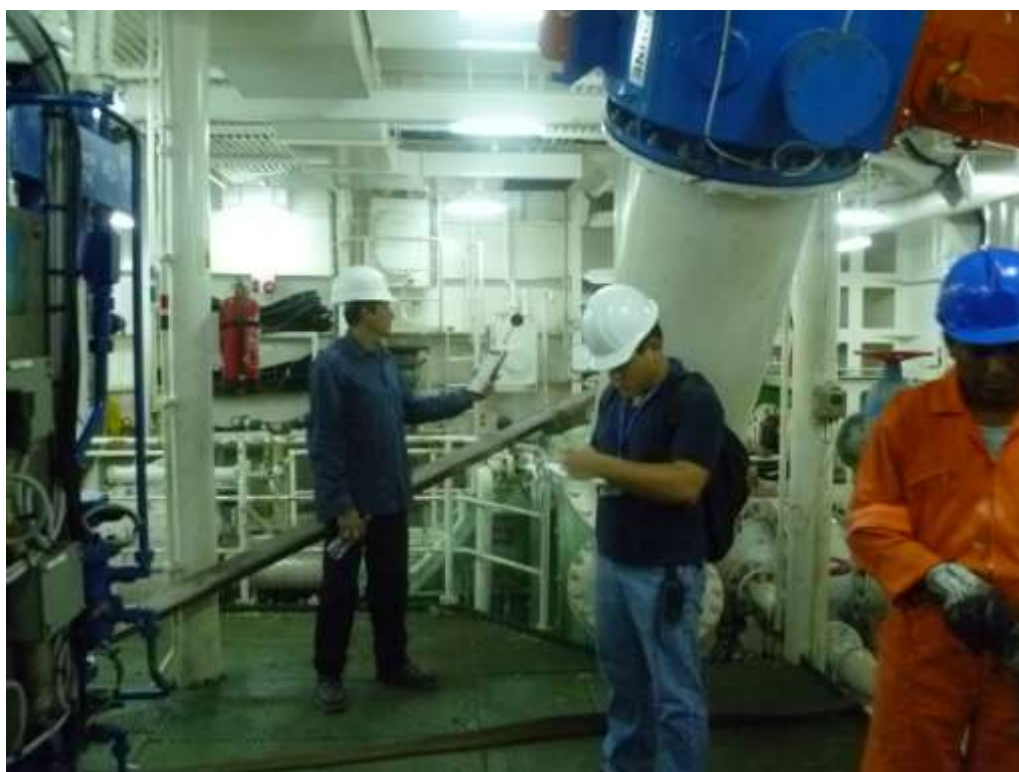
Fotografía 2. Mediciones de ruido en sala de bombas de Draga Francisco de Orellana durante su permanencia en el Dique de la Armada del Ecuador.
