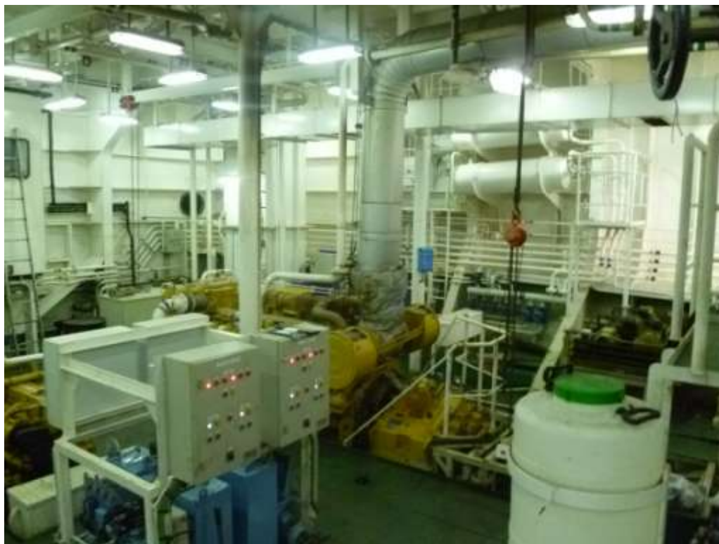
Fotografía 4. Vista general de sector de sala de máquinas de la draga sometida a trabajos de mantenimiento en dique de la Armada del Ecuador.
